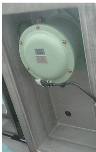
パイプレーター部
