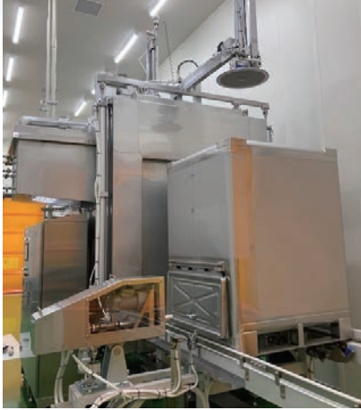
トートビン洗浄乾燥装置
